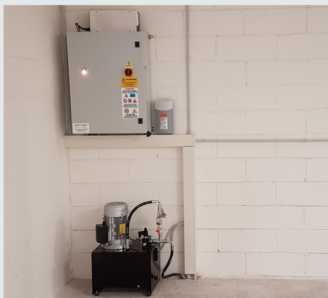
QUADRO MACCHINA E CENTRALE IDRAULICA
