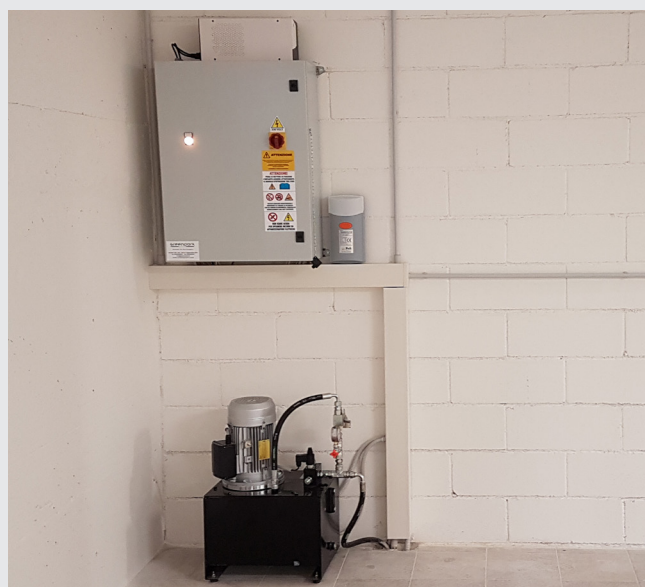
QUADRO MACCHINA E CENTRALE IDRAULICA
